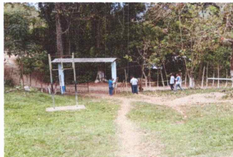
Foto 2: se observa la medición del cerco perimetral arruinado.
